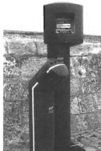
Figure 24.16 • Borne de charge sur voie publique.
