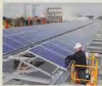
6. Panneaux solaires (France)
