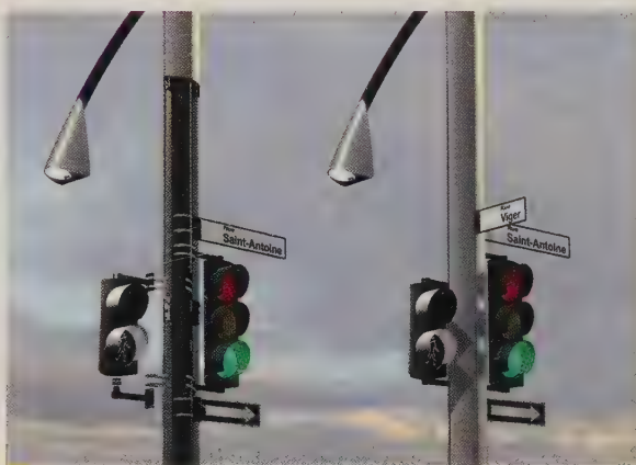
Les feux de circulation utilisent des DEL.
